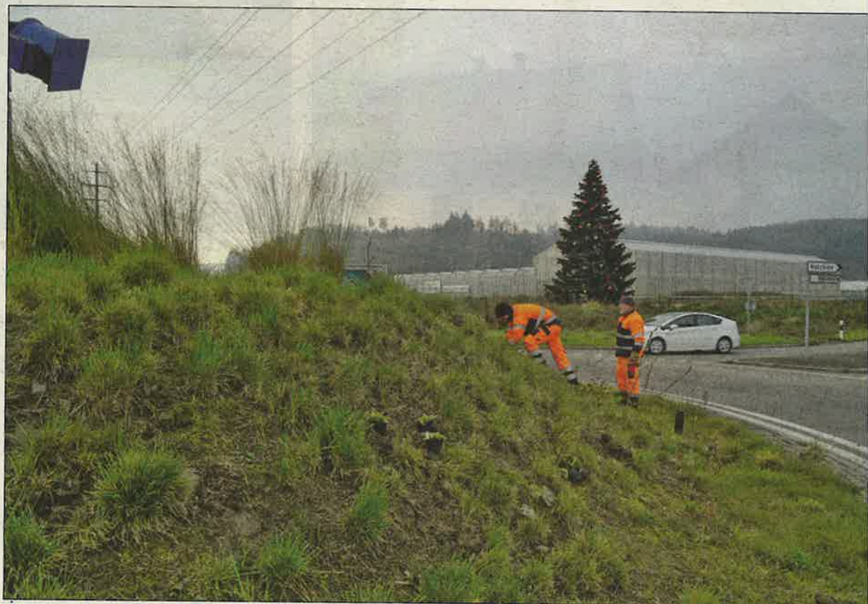
Über 100 Stauden werden gepflanzt: Seit November 2020, exakt 17 Jahre nach seiner Entstehung, wird der Kreisel Riggerbach aufgewertet. (Bild: z)
