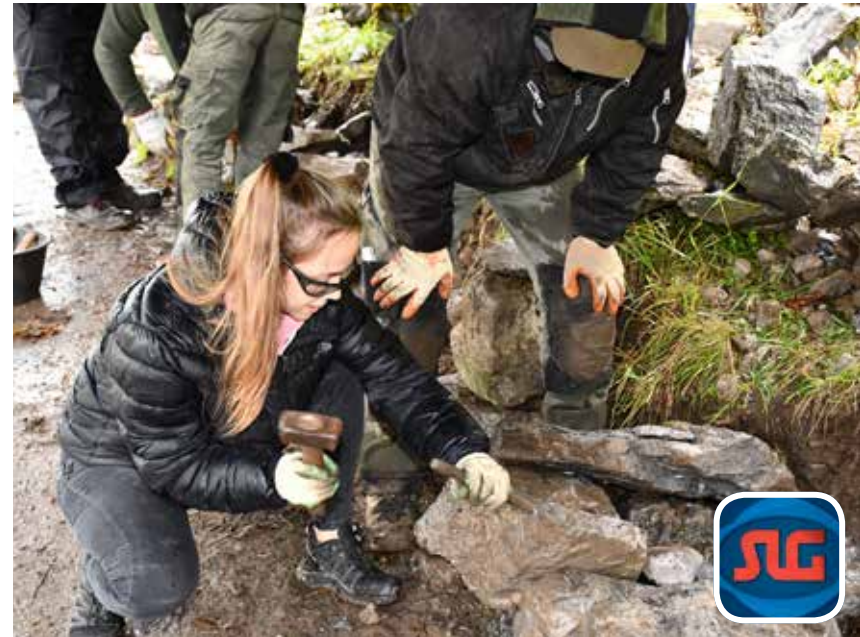
Kein alltäglicher Bürojob: Trockensteinmauern zu bauen, erfordert gutes Augenmass und viel Körpereinsatz.
